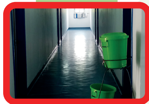
2. Chambres du CT-Epi de Gbessia à Conakry (couloir)
